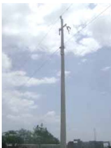
APLIACION DE RED ELECTRICA EN COL. ALTAVISTA
