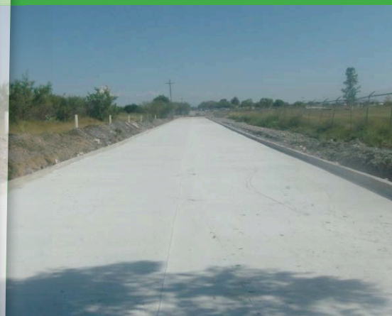
PAVIMENTACION DE CONCRETO HIDRAULICO DE CALLE CAMINO AL OLMO DE CALLE REMIGIA GONZALEZ A ACCESO A UNIDAD DEPORTIVA "REVOLUCION VERDE", COL.PEDRO JOSE MENDEZ II
