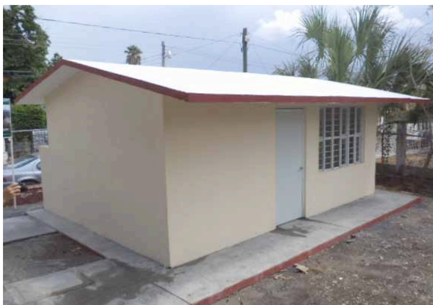
CONSTRUCCION DE DESAYUNADOR EN JARDIN DE NIÑOS "AMALIA G. DE CASTILLO LEDON"
